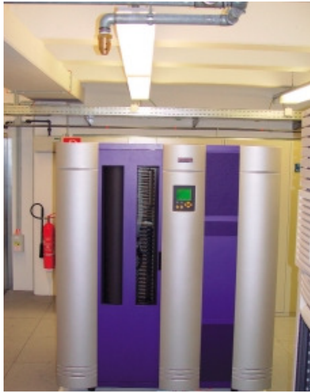
Ochrona serwerowni systemem KD-200
