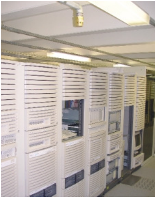
Ochrona serwerowni systemem KD-200
